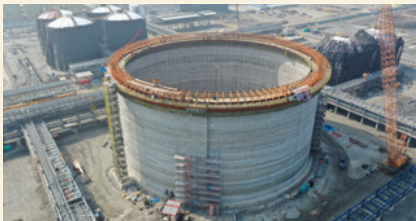
▲ 外槽完成滑模爬升 28M，目前進行預力施作及內槽焊接施工。
