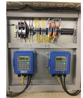
冰機流量計及數位電錶系統
